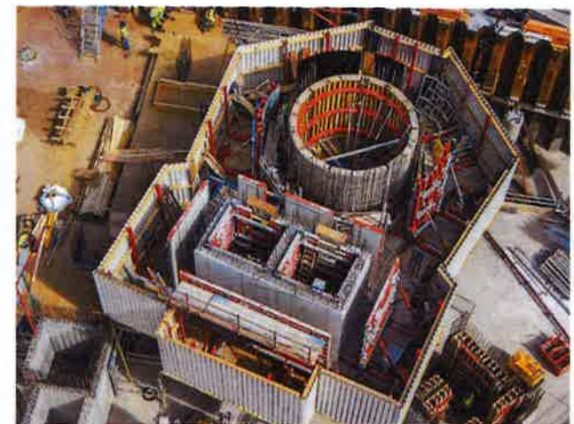
Auch komplexe Geometrien mit unterschiedlich großen und versetzten Bauteilen sind mit dem geführten Klettersystem MGC problemlos zu meistern.
