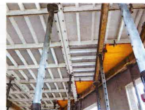
Weniger bauseitige Lösungen sparen Geld. Reibungslose Anschlüsse an konventionell geschaltete Bereiche.
